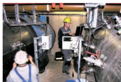
Montage der deltaxwave-Messsysteme im Kraftwerk Mittelsbüren der swb-Erzeugung, Bremen
