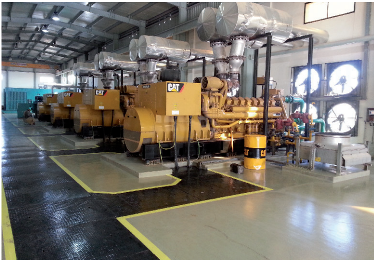
Bild 1 Die Dieselmotoren im Kraftwerk.
