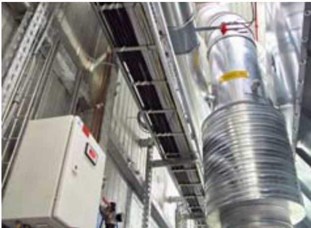
Die Chemolux-Fertigungsanlage mit den deltaflow-Installationen
