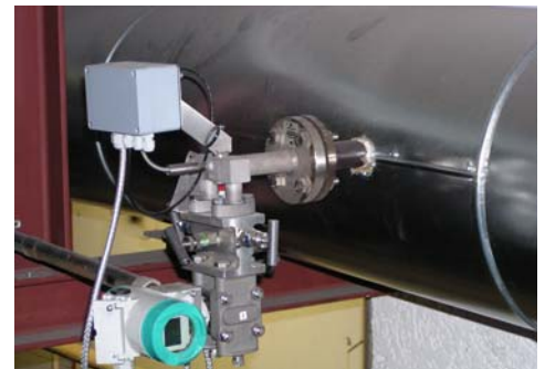
Abbildung 3: deltaflow für Dampfleitung mit direkt montiertem dp-Transmitter (auf Dreibeinblock), integrierter Temperaturmessung und Anschlusskasten (für Verkabelung)
