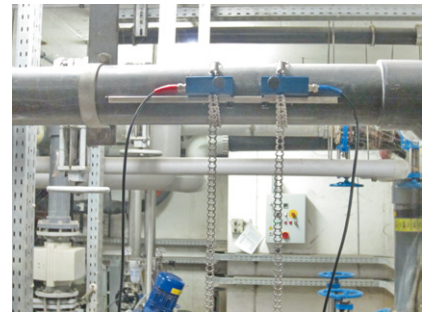
Wärmemengenmessung Stadtwerke München
